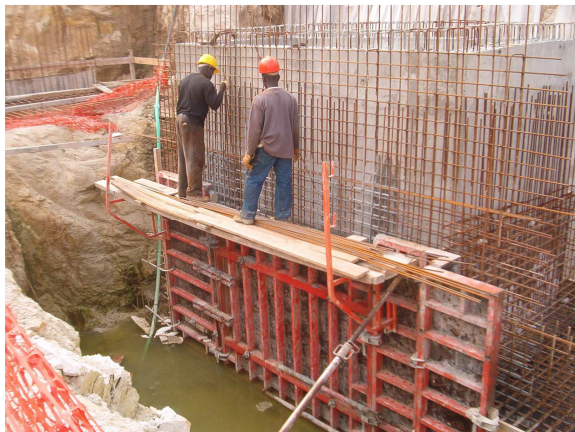
Foto nº 7: Plataforma de trabalho sem protecções nem acessos nas paredes de betão dos depósitos
