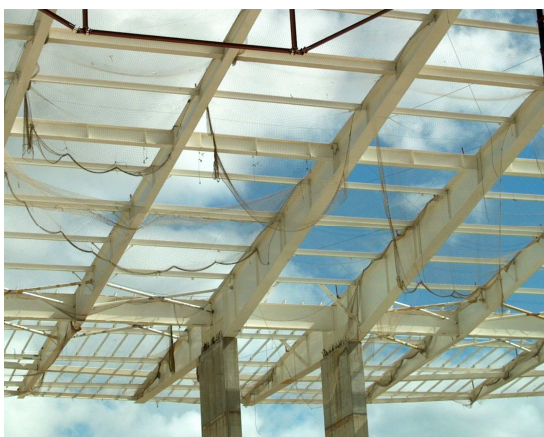
Figura 26 - Redes de protecção para evitar quedas em altura
