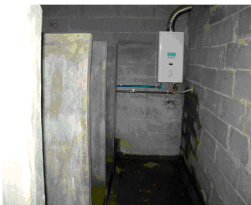
Figura 1 – Péssimas condições de salubridade; localização de esquentador não cumpre regulamentação aplicável a projectos de gás
