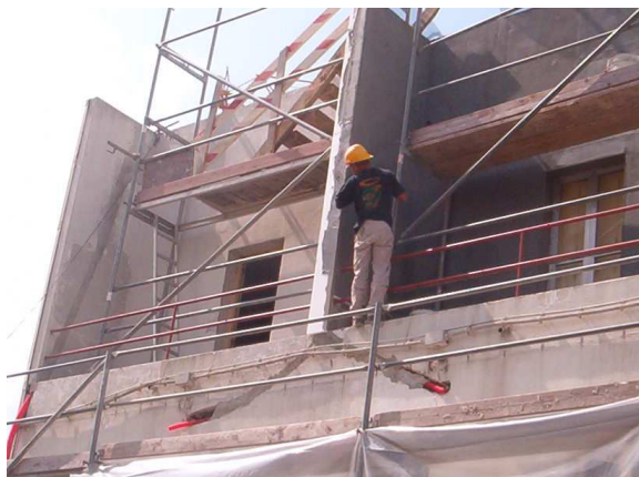
Foto nº 1: Operário a trabalhar no topo da parede para vistas dependurado na varanda
