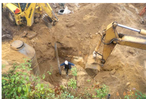
Figura 7 – Máquinas e homens a trabalhar demasiado próximo
