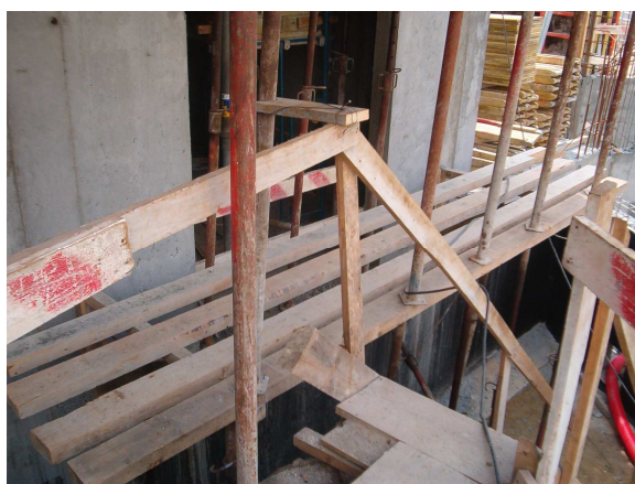
Foto nº 3: Plataforma de trabalho sem protecções e soalho com aberturas
