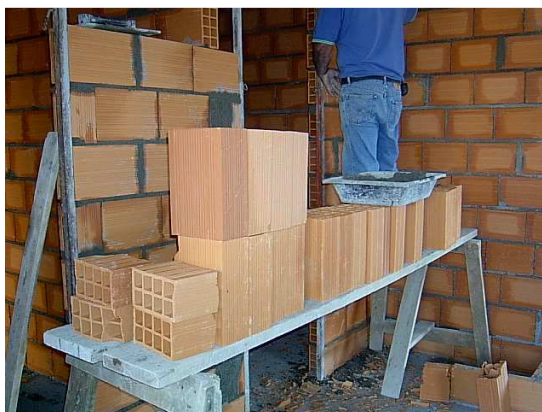
Figura 14 - Andaime de trolha com muito más condições
