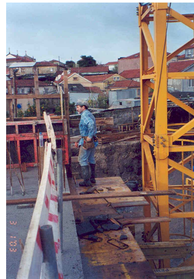
Figura 4 – Ausência de protecção colectiva contra quedas em altura
