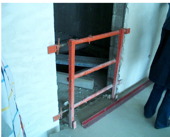
Figura 30 - Protecção contra quedas em altura adequada
