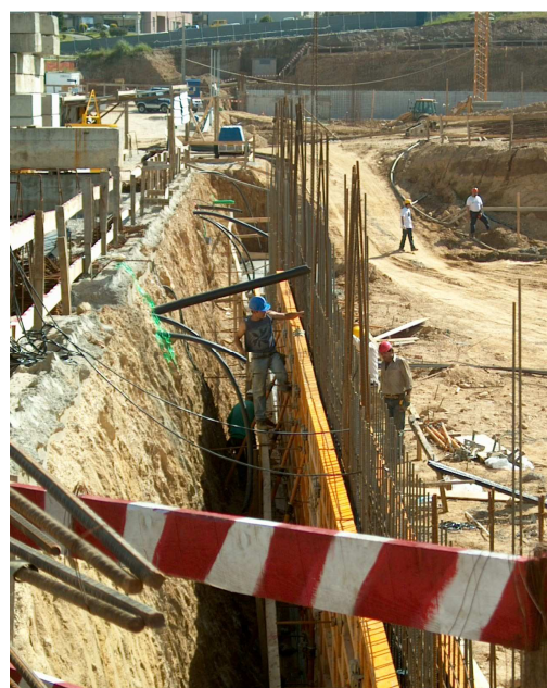
Figura 18 - Trabalhos entre talude e cofragem em más condições
