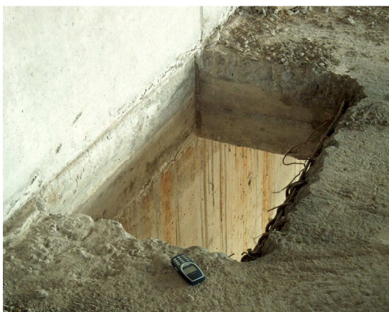
Figura 11 - Ausência de protecção contra quedas em altura
