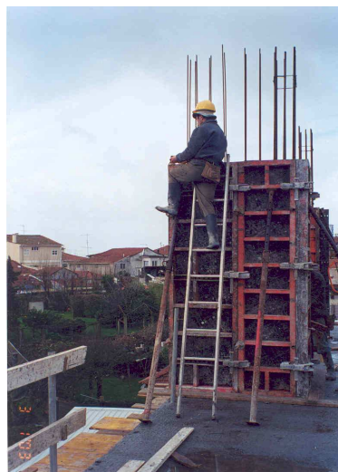
Figura 5 – Mau acesso para trabalhos em pilares
