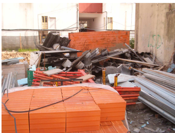
Foto nº 9: Zona do estaleiro desorganizada com materiais misturados com equipamentos, garrafas de gás e detritos das coberturas
