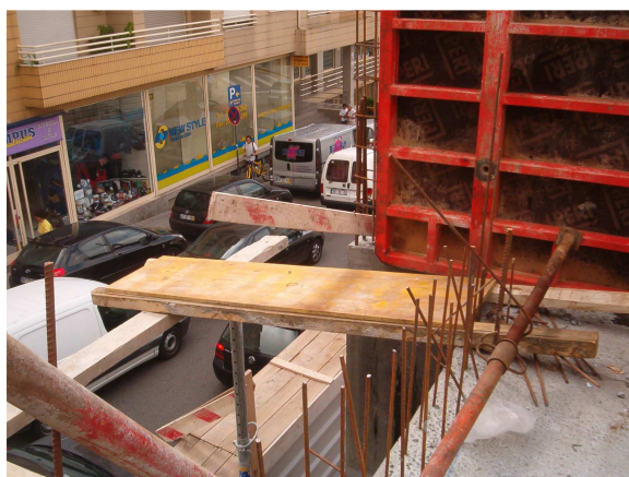
Foto nº 5: Periferia da laje sem protecção. Plataforma de trabalho por terminar, sem qualquer protecção
