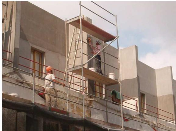
Foto nº 2: Exemplo de andaime que devia existir em toda a fachada para executar os trabalhos. Ausência de guarda-corpos nos topos e de rodapés
