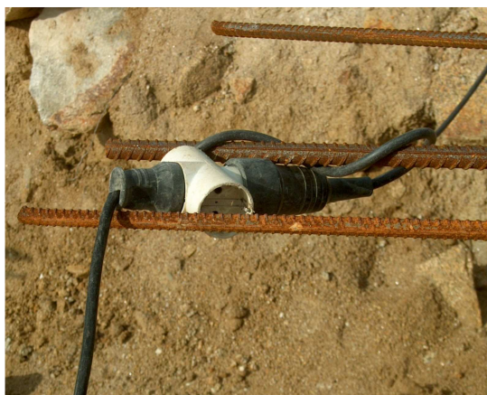
Figura 19 - Ligação eléctrica em más condições
