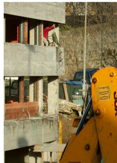
Figura 6 – Vazadoiro de entulho em péssimas condições de segurança
