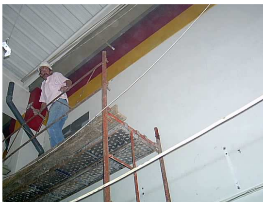
Figura 12 - Andaime não respeita norma
