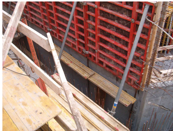
Foto nº 6: Plataforma de trabalho na parede de betão totalmente inadequada
