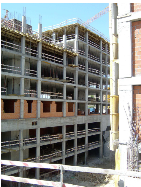
Figura 17 - Ausência de protecção colectiva para quedas em altura
