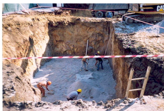
Figura 8 - Ausência de entivação
