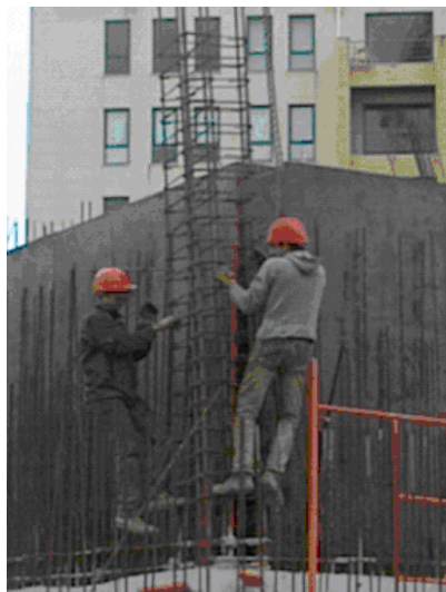
Figura 3 - Ausência de acesso adequado à zona de trabalho
