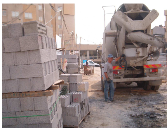
Foto nº 10: Após entrada do camião betoneira deve ser fechado o portão não vigiado. O operador da betoneira tem que usar os EPI's adequados (capacete e botas)
