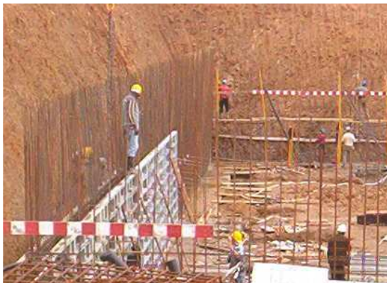
Figura 9 - Talude com inclinação excessiva; trabalhos de betão armado sem adequadas condições acesso – plataformas de trabalho
