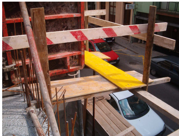
Foto nº 4: Plataforma nos pilares sem guarda-corpos intermédio e sem rodapés essenciais devido à proximidade da rua. Periferia da laje sem protecção
