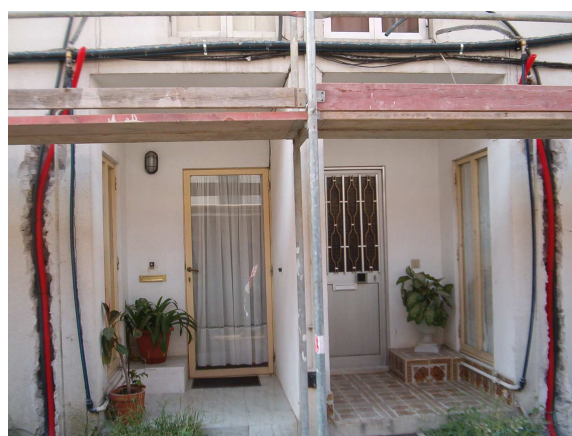
Foto nº 12: Nas entradas das habitações vão ser colocadas coberturas de protecção contra queda de objectos ou materiais
