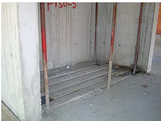
Figura 13 - Protecção inadequada para quedas em altura
