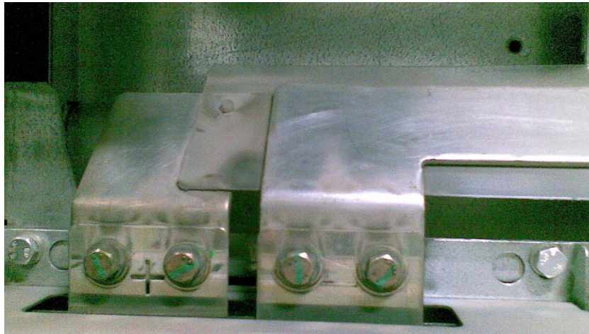
Figura 15 – Barramento DC com sujidade intensa e indícios de pontos quentes e picagem.
