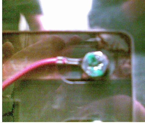
Figura 17 – Parafuso de um condensador electrolítico com aperto incorrectamente controlado.
