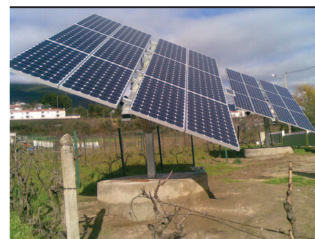
Figura 2 A matriz fotovoltaica da instalação de micro-geração localizada na Covilhã.
