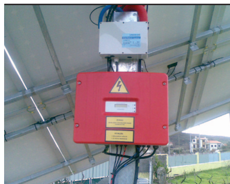
Figura 6 O inversor fotovoltaico está localizado na estrutura da matriz fotovoltaica, debaixo dos módulos fotovoltaicos.
