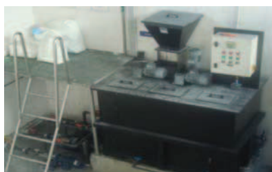
Figura 11. Equipamento de preparação e transporte do floculante.
