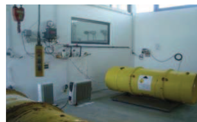
Figura 20. Sala de armazenamento de cloro.
