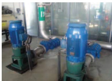
Figura 16. Grupo de eletrobombas.
