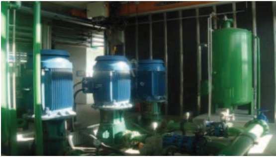
Figura 22. Estação elevatória de adução à rede X.
