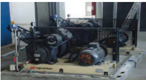
Figura 24. Grupo de compressores afectos aos RAC.
