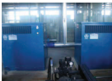
Figura 17. Grupo de compressores.
