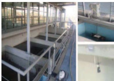
Figura 15. Filtros de areia.
