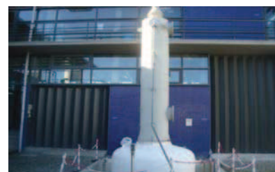
Figura 21. Torre de neutralização de cloro.
