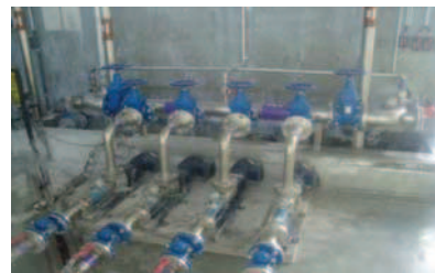
Figura 12. Eletrobombas para transporte do leite de cal.
