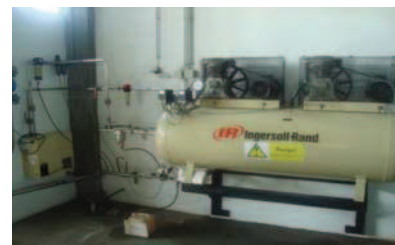
Figura 19. Compressor de ar comprimido de serviço à instalação.
