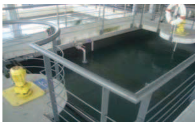
Figura 8. Tanque de mistura lenta.
