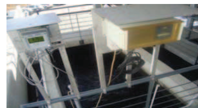
Figura 6. Tanque de água bruta com equipamentos de medição.
