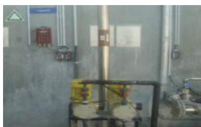
Figura 10. Eletrobombas de transporte do coagulante.
